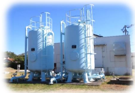
梅田浄水場内（急速ろ過機）
