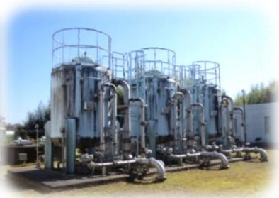
高田浄水場内（急速ろ過機）
