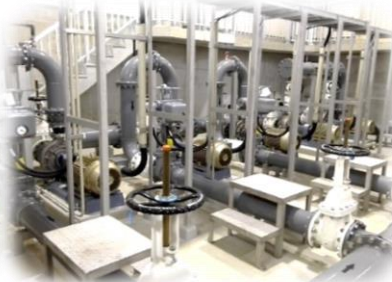
腹赤浄水場内 (加圧ポンプ設備)
