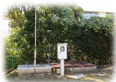
腹赤浄水場内 (第3水源)
