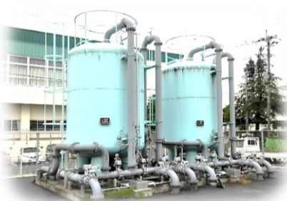
腹赤浄水場内 (急速ろ過機)
