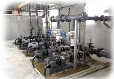
梅田浄水場内（加圧ポンプ設備）
